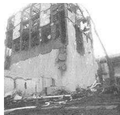
福島第一原発 4 号機で作業するコンクリートポンプ車=22日、福島県大熊町、東京電力提供 Wikipedia「福島第一事故」
