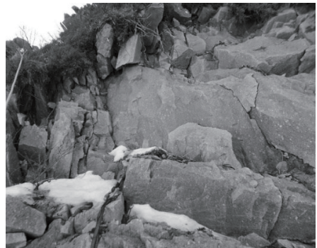
核心部は崩落消滅していた
